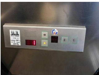
Haupthaus: Aufzug EG – OG
