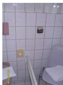
Duschbereich mit Duschsitz und Haltegriffe
