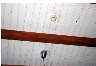
Rauchmelder in allen Räumen
