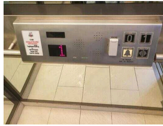
Aufzug zum Bad- Saunabereich
