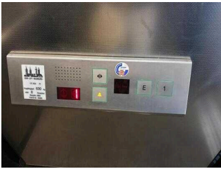
Haupthaus: Aufzug EG – OG
