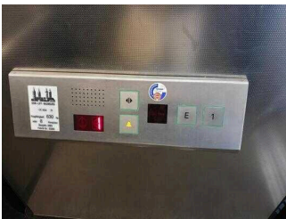
Haupthaus: Aufzug EG – OG
