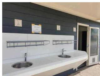
Außenbereich am Hauptsanitärgebäude: Waschbecken
