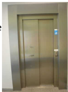
Bedienelemente Aufzug zum VIP-, Veranstaltungsbereich
