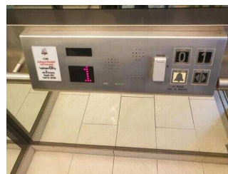
Aufzug zum Bad-Saunabereich
