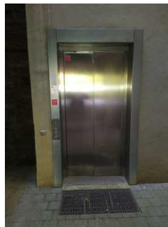
Aufzug 2 im Torhaus ©Manuela Fischer
