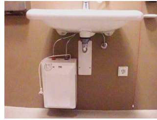
Der Warmwasser- Boiler unter dem Waschtisch ist problematisch
