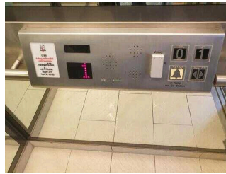
Aufzug zum Bad-Saunabereich
