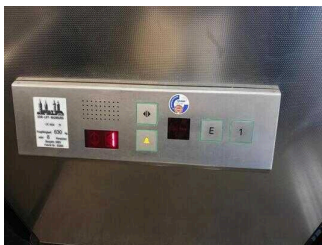
Haupthaus: Aufzug EG – OG
