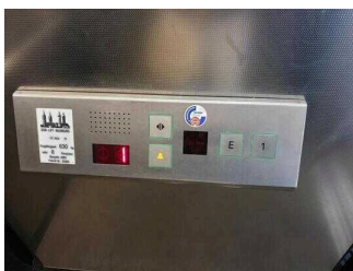
Haupthaus: Aufzug EG – OG
