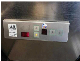
Haupthaus: Aufzug EG – OG
