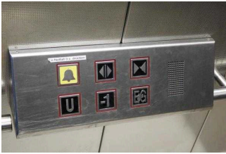
Bedienelemente im Aufzug
